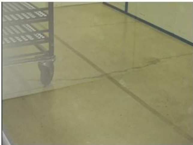
Outro detalhe de trinca térmica no piso de concreto no Setor de Pintura junto à Estufa.
