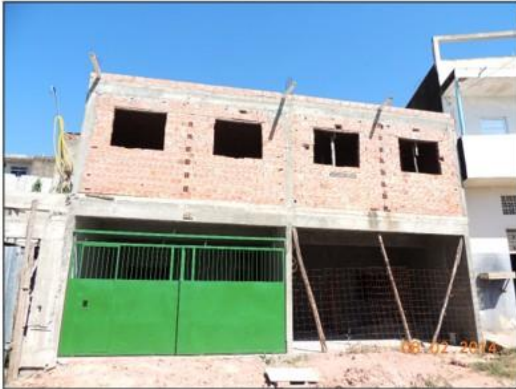
Foto da fachada do imóvel em questão, tirada na Diligência de 08/02/2014, quando da elaboração do Laudo Prévio, mostrando o estágio da Obra executada, inacabada.
