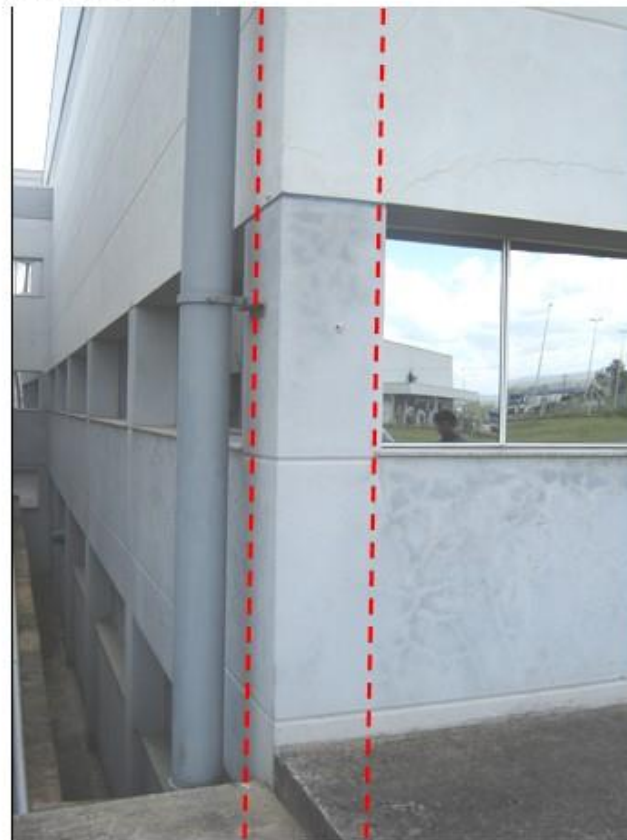
Detalhe das trincas no pilar (assinalado em cor vermelha ) que recalcou, junto ao Escritório / Setor E do Prédio 1.
