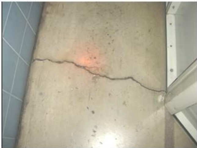
Detalhe de trinca térmica no piso de concreto no Setor de Pintura junto à Estufa.
