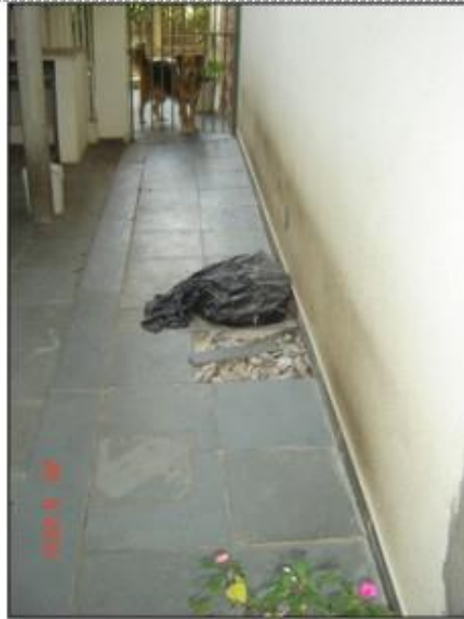
Rachaduras e recalques em pisos.
