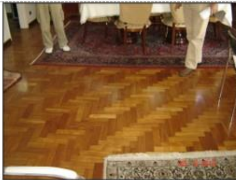
Recalques causando desnivelamento acentuado dos pisos.
