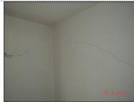
Rachaduras e trincas em paredes, devido a recalques referenciais de fundação.
