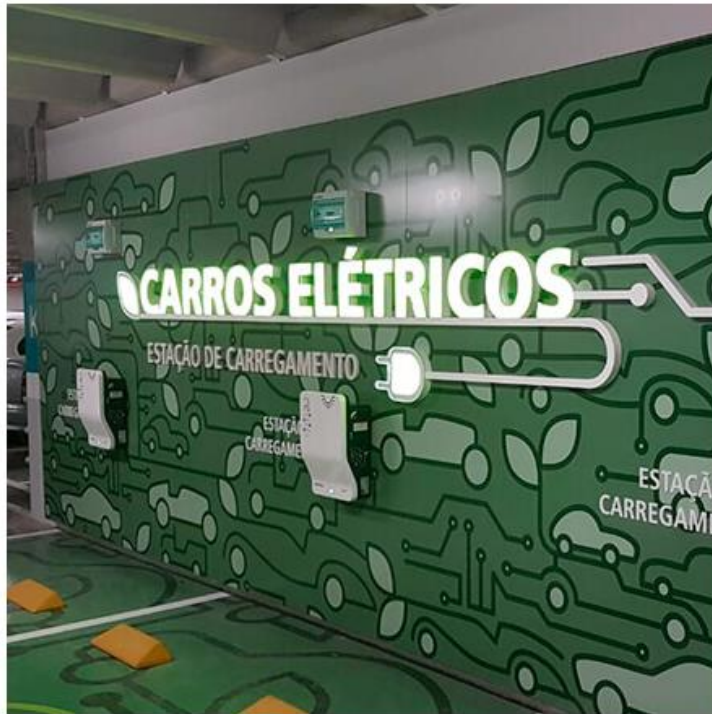
Estação de carregamento de veículos elétricos no Shopping Estação Cuiabá
