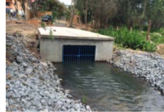
Bombeamento de 1,0 m 3 /s do Rio Guaió para o Represa Taiacupeba.
